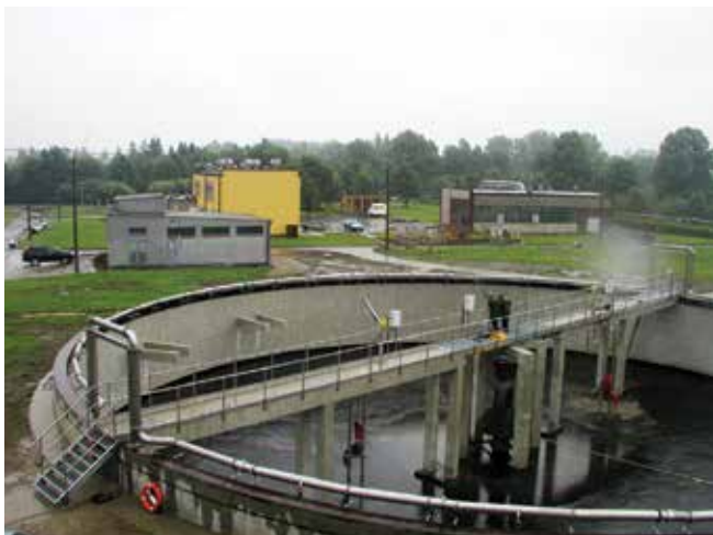
W 2012 roku zakończono modernizację Oczyszczalni Ścieków (na zdjęciu) oraz ukończono budowę kanalizacji sanitarnej w Cieszynie Mniszowie i w rejonie ul. Pikiety i Przepilińskiego. (fot. JRP)
